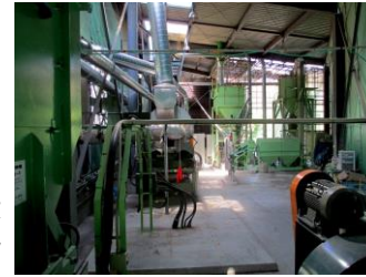
右図： 木質バイオマス加工流通施設 乾燥キルン・成形・冷却・梱包 (安岡重機様より提供)
